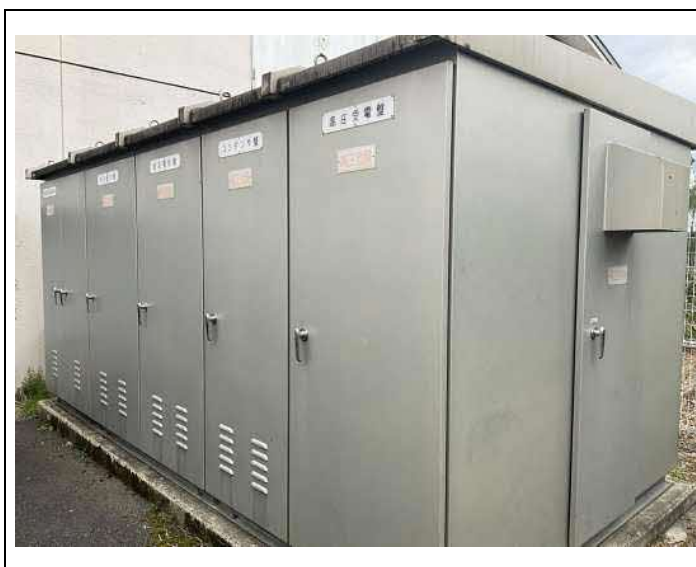
写真 No.15 電気設備
