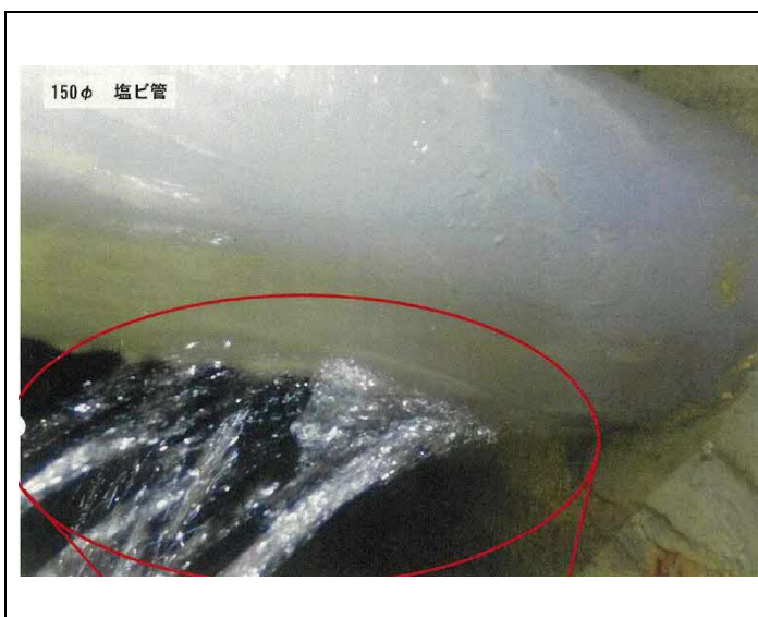
写真 No.16 給排水給湯設備
