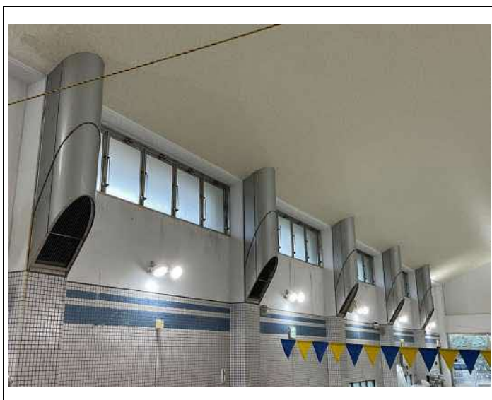
写真 No.20 換気設備
