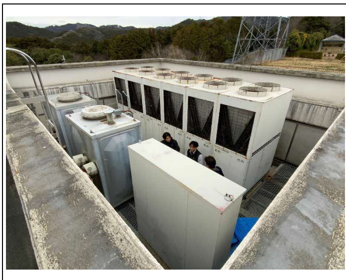
写真 No.18 空調設備
