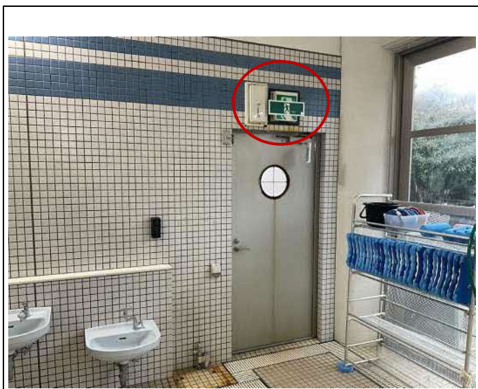
写真 No.19 消防設備
