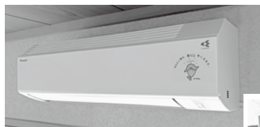
▲薬水区の購入備品 (エアコン)
